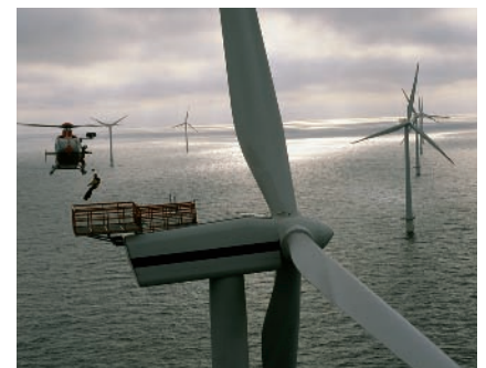
Fig. 8.5. Parque eólico marítimo en Dinamarca. La energía eólica o la solar son rentables, pero aún queda mucho camino que recorrer. Las instalaciones son muy especializadas y el mantenimiento muy costoso.
